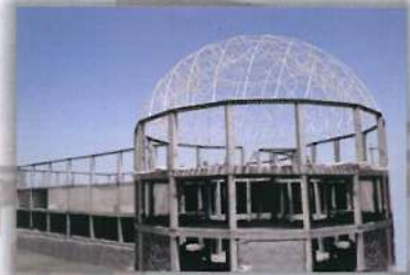
مرکز تجاری گلستان - شهرک مکانشهر - اردبیل تقویت سازه بتنی به روش Steel Jacketing و FRP به دلیل تغییر سیستم سقف
