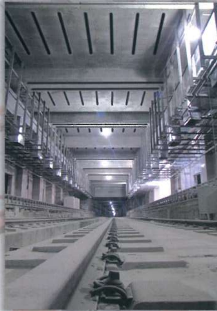
مترو شیراز - تقویت تیرها و دالهای سقف ایستگاه مترو با FRP برای افزایش ظرفیت باربری سقف
