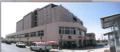
مجتمع تجاری الناس - تهران - چهارراه مینی سیتی بهسازی لوزه ای و تقویت سازه بتنی با FRP
